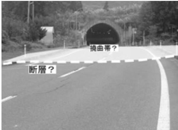
写真1 小平尾地区の道路の変形その1 (2004/10/30撮影)
